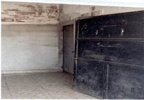
Foto 3: Muro perimetral en mal estado
