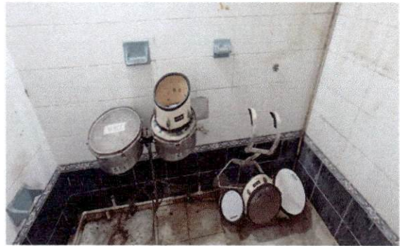
Foto 2: Servicio sanitario en mal estado
